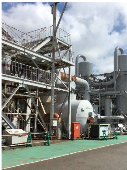
八丁原地熱発電所
